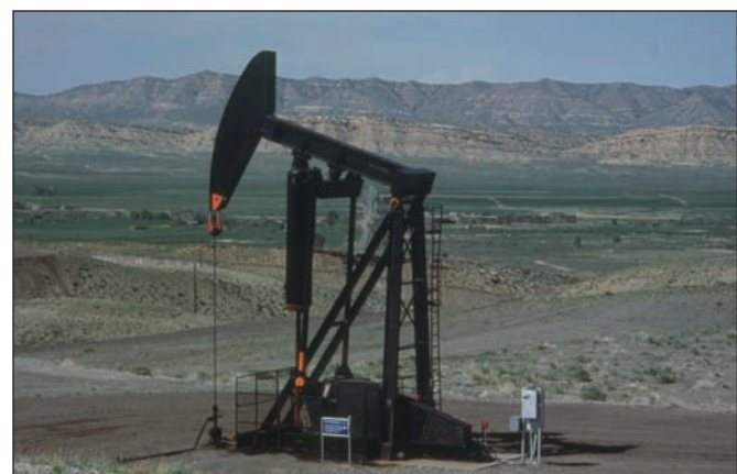
Станок-качалка с пневцилиндром с приводом от электродвигателя.
