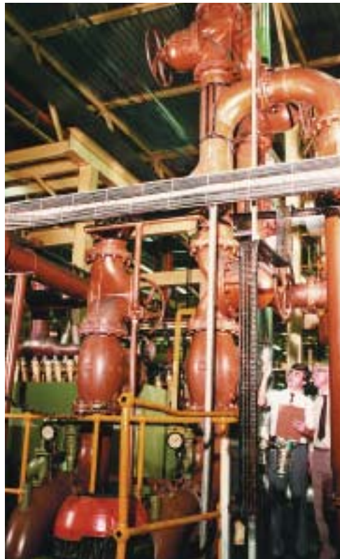
Клапаны большого размера типа А, установленные на перегородной установке
